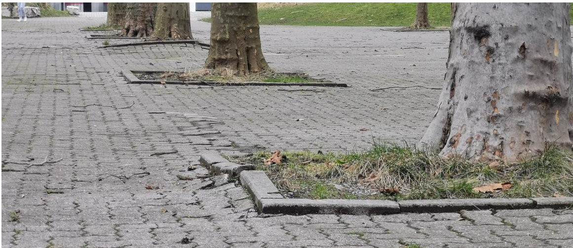
Abbildung 1 (2 Fotos): Verdrückungen des Pflasterbelags durch Wurzelhebungen
