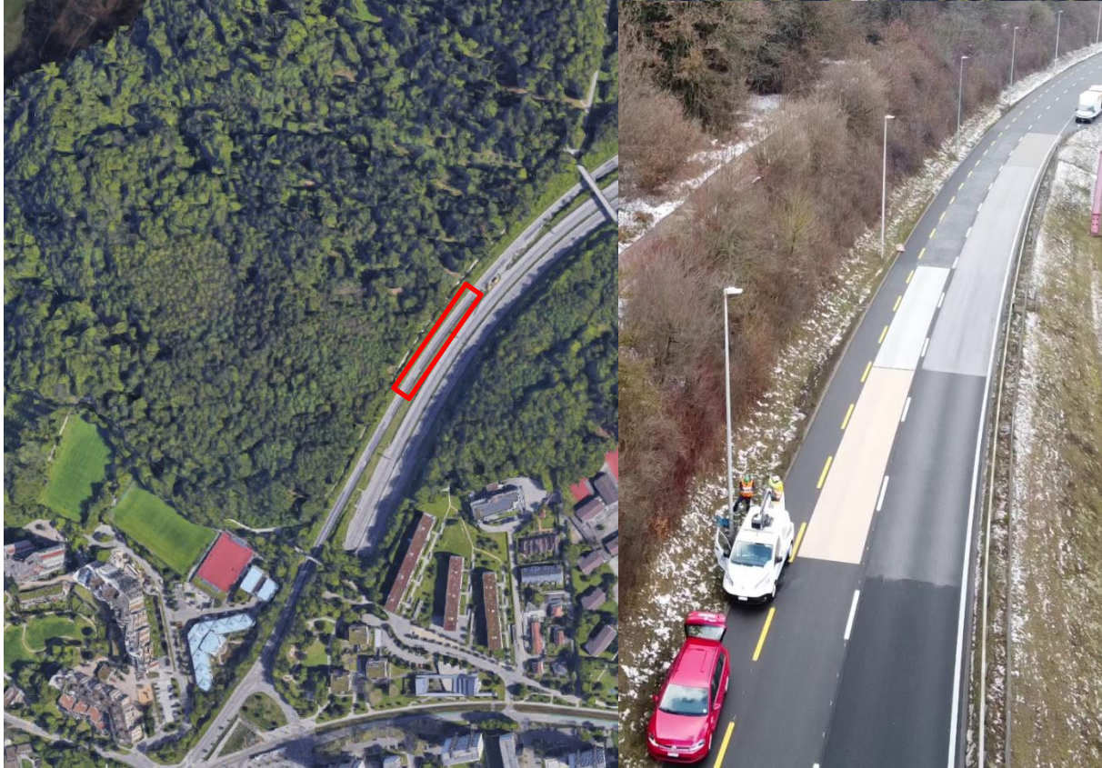
Abbildung 3: Standort Neue Murtenstrasse Bern (gekennzeichnet) und Luftaufnahme der eingebauten Belagsabschnitte (Quelle: eigene Darstellung, Google Maps)
