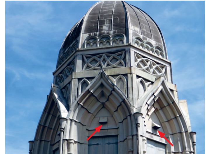
Im Kirchturm eingebaute Nistplätze.
