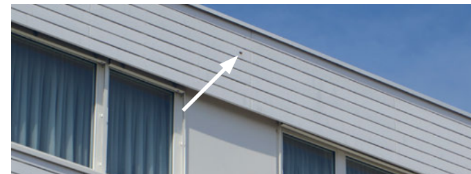
Nistkasten hinter Holzverschalung.
