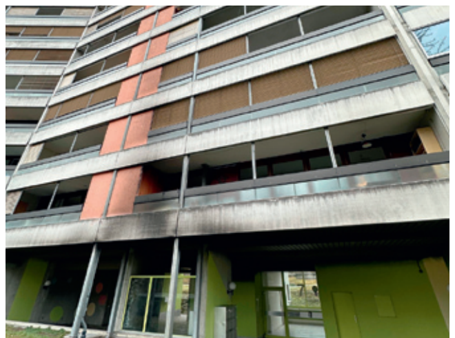
Die verrusste Fassade.
