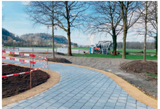
Hochwasserschutzmassnahmen beim Weg zum Schaustellerplatz Schachen.
