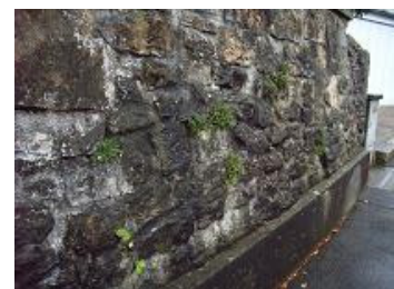
Ritzenvegetation an Abgrenzungsmauern
