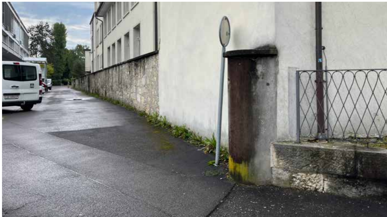
Entlang der nördlichen Parzellengrenze besteht heute eine klassische Mauer und dahinter befindet sich ein schmaler privater Aussenraum
