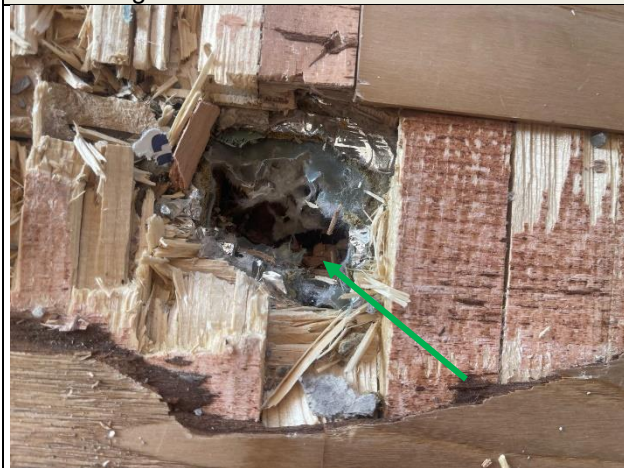
ID-15: Isolation Standort: EG / Zimmer Bemerkung: kein Asbest festgestellt
