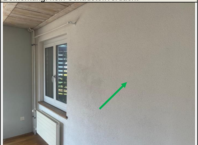
ID-12: Verputz Wand Standort: EG / Zimmer Bemerkung: kein Asbest festgestellt
