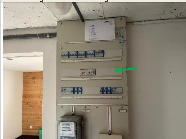
ID-25: Elektrotabelleau neu Standort: UG / Heizungsraum Bemerkung: kein Schadstoffverdacht
