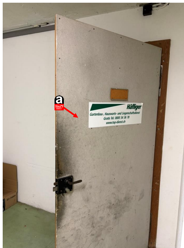
Abb. 3: Faserzementplatte an Tür.
