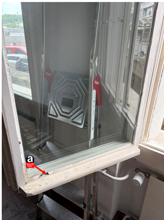
Abb. 9: Fenster mit asbesthaltigem Kitt.
