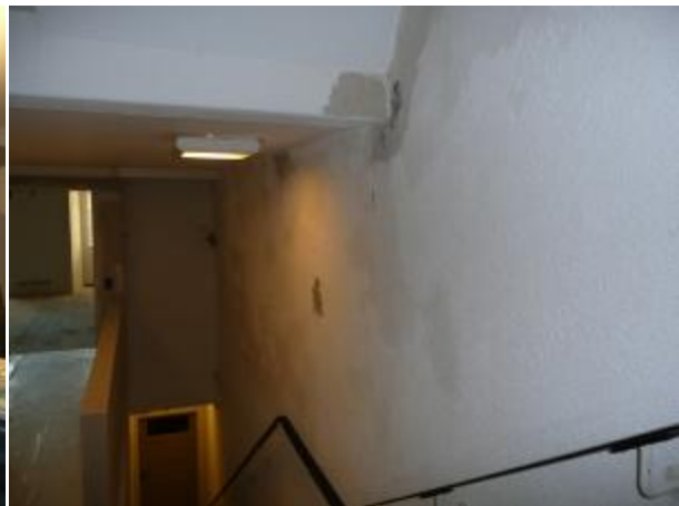
Abb. 2: Feuchtigkeitsschäden Treppenhaus 2. UG – 3. UG
