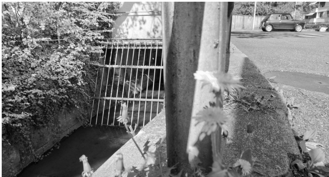
Nach Einschätzung der kantonalen Behörden könnte der Bach an verschiedenen Stellen – wie hier beim Einlaufbauwerk Herzogplatz – über die Ufer treten. Hochwasserschutzmassnahmen sind vorgesehen.
