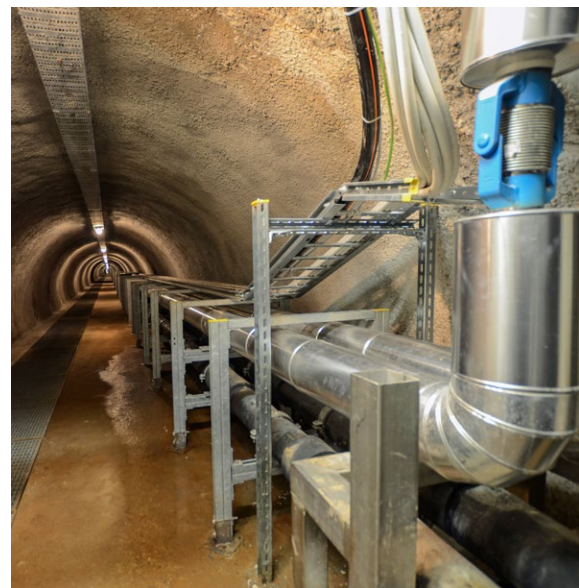
Ein alter Zugangsstollen führt quer unter der Stadt direkt zum Grundwasserbrunnen am Ufer der Aare. In diesem Stollen wird in Leitungen das Aaregrundwasser zur Energiezentrale transportiert.
