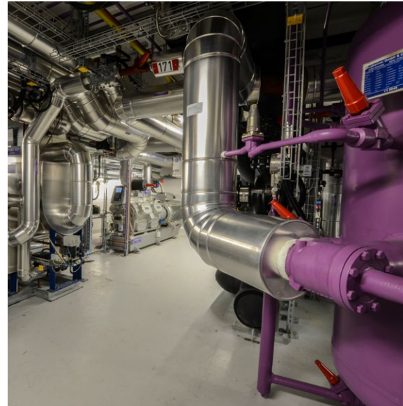
Im Untergeschoss des Kasinoparkhauses entziehen Wärmepumpen dem Grundwasser Energie und produzieren damit 75 Grad heisses Wasser sowie Kaltwasser fürs Fernwärme -und Fernkältenetz.
