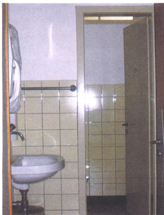
Zustand heute: Die WC-Anlagen für Mitarbeiterinnen und Mitarbeiter sowie Besucherinnen und Besucher sind seit 50 Jahren unverändert und sind sanierungsbedürftig.
